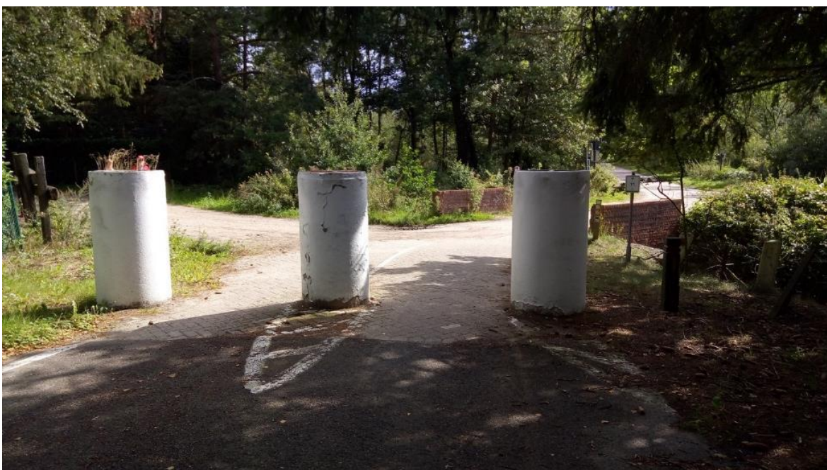
Rycina 6. Typowe słupki są podatne na akty wandalizmu w odległych obszarach wiejskich, dlatego czasami stosuje się bardziej wytrzymałe konstrukcje, aby zapobiec niedozwolonym przejazdom.
